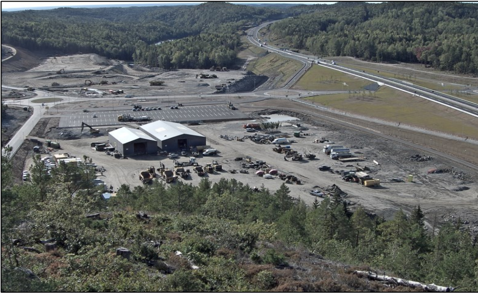
Bilde 1: Dagens situasjon per 17.09.2019 sett nordfra. Fra høyre: E18, påkjøringsrampe til E18 fra rundkjøringen, støyskjerm, gang- og sykkelvei,
